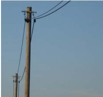
Abbildung 14: Freileitungen an Holzmasten
